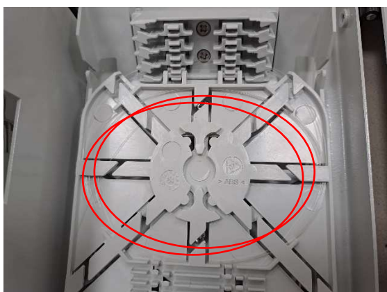
DISPERSIONE DELLA FIBRA NEL MODULO DI GIUNZIONE DOPO ESSERE STATA GIUNTATA.
